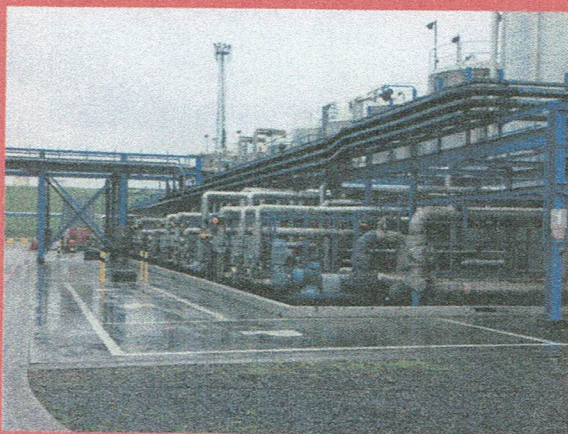
De meest gangbare additieven worden buiten in bulk opgeslagen. De minder gebruikte zitten in vaten.
